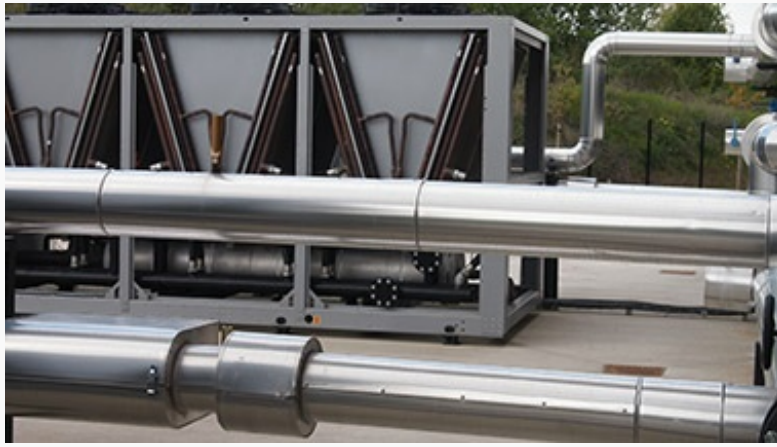
Installation extérieure freecooling
